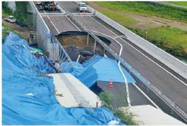
日本海沿岸東北自動車道の陥没箇所
