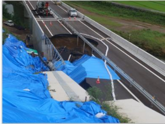
日本海沿岸東北自動車道の被災現場
